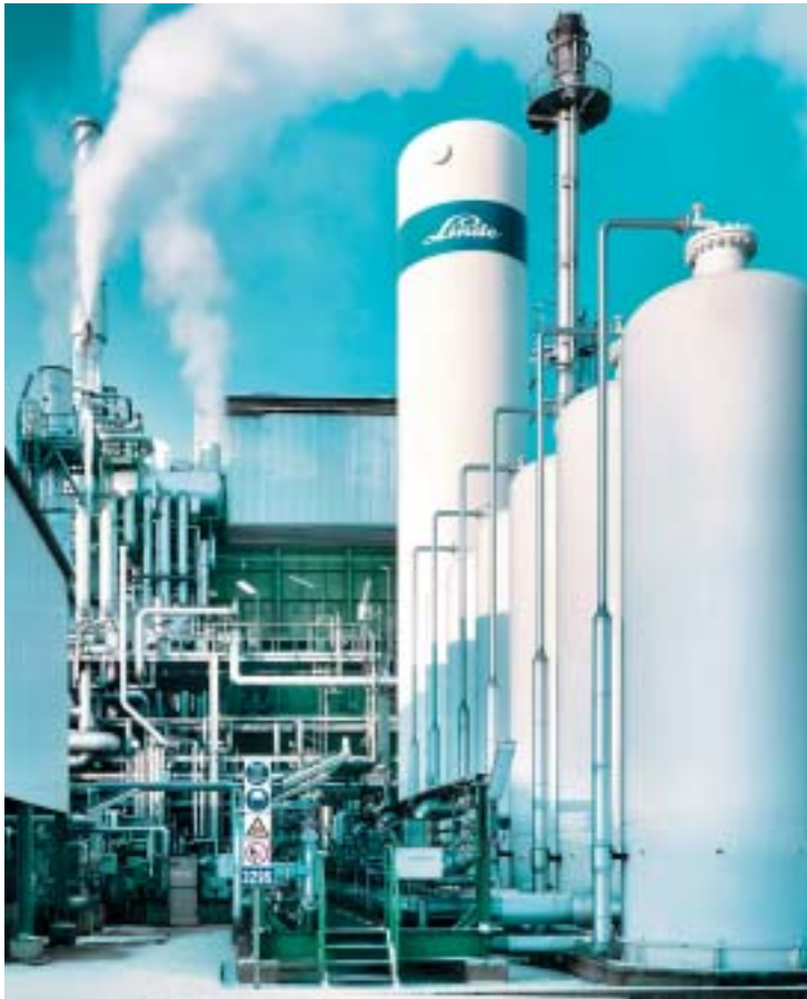
Linde-Wasserstoffanlage in Brunsbüttel: Von hier muss das Gas zu den Kunden transportiert werden.
